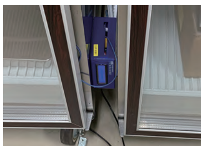
機器の隙間へもコンパクトに収まっている。
